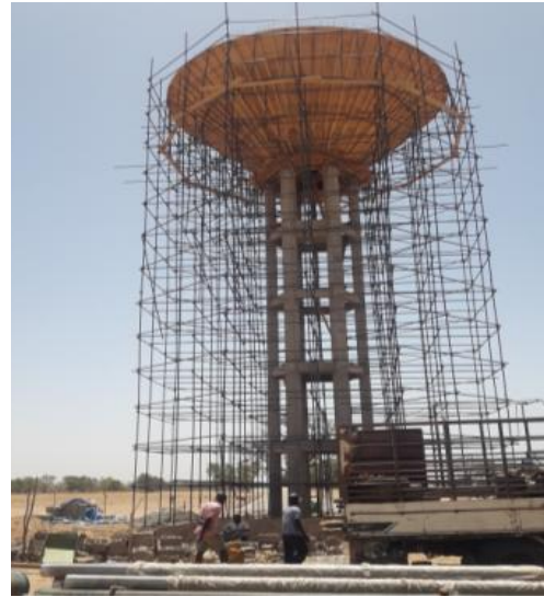
Château d'eau de sinthiou thiakhate
